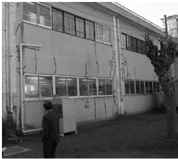
▲ 柿岡中のクラック補修あと
