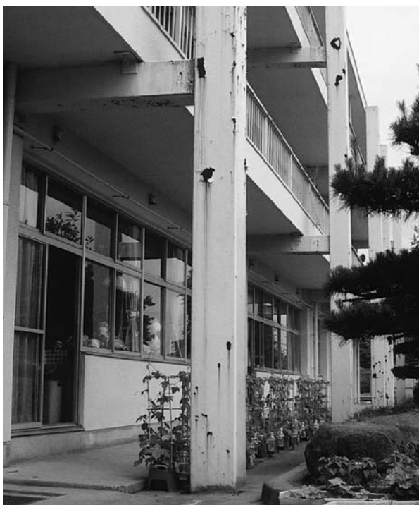
▲ 北小のバルコニーに施されている補強
