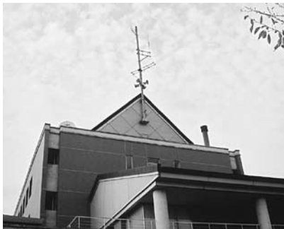
▲ 総合支所にある防災行政無線基地局空中線
