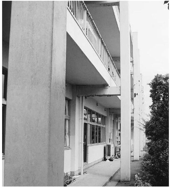
▲ バランダに補強用の鉄骨が入った北小学校の校舎
